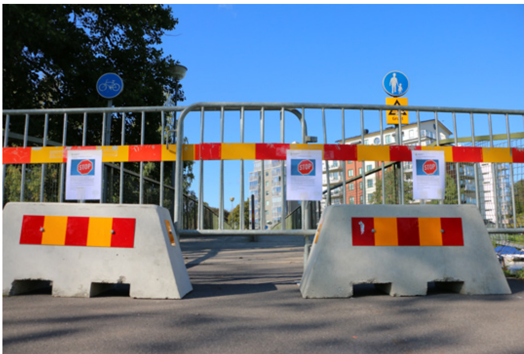
Gröna bron stängdes i fredags sedan man funnit att den bärande konstruktionen är kraftigt rostangripen. Foto: Fredrik Norman
