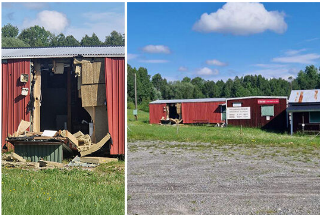
Linde MSK:s anläggning efter tjuvarnas framfart. Foto: LäsaBild
