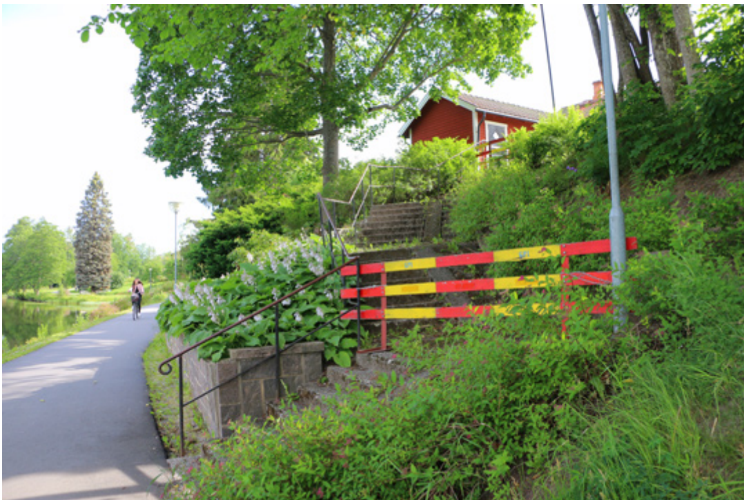
Farlig trappa vid Strandpromenaden skall bli säker att använda igen. Foto: Fredrik Norman
