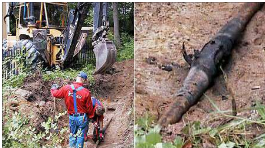
Boven lokaliserad: Kabelbrottet var på samma ställe som vid ett tidigare tillfälle.
