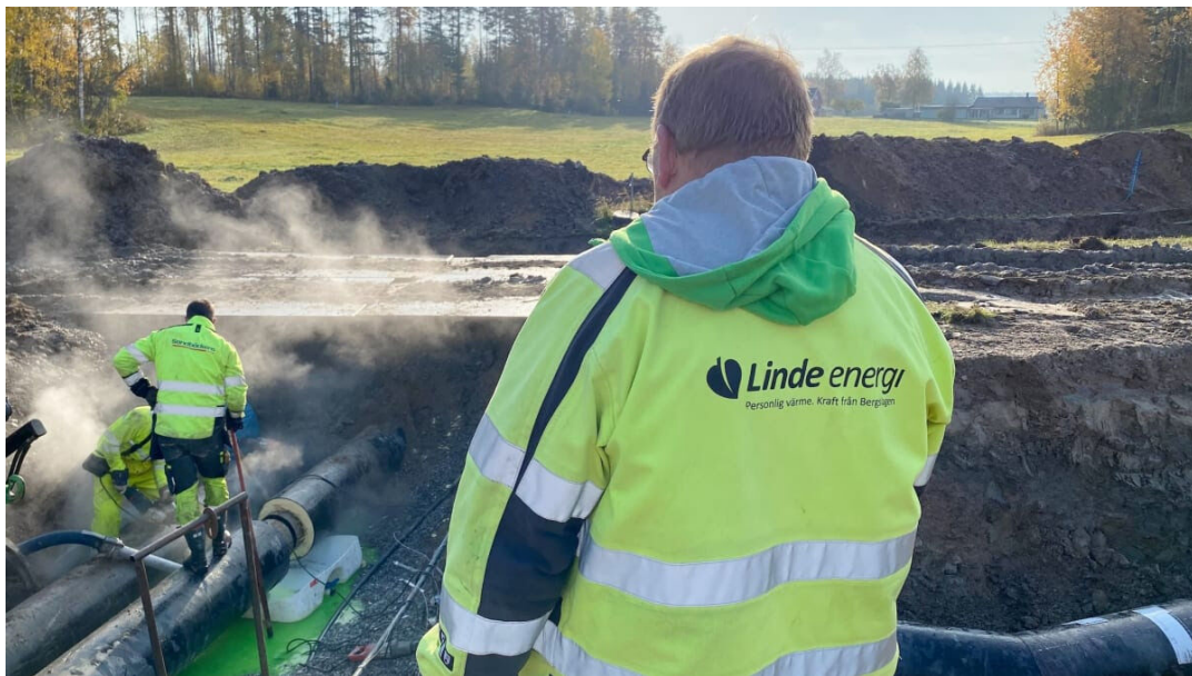
Foto: Linde energi
