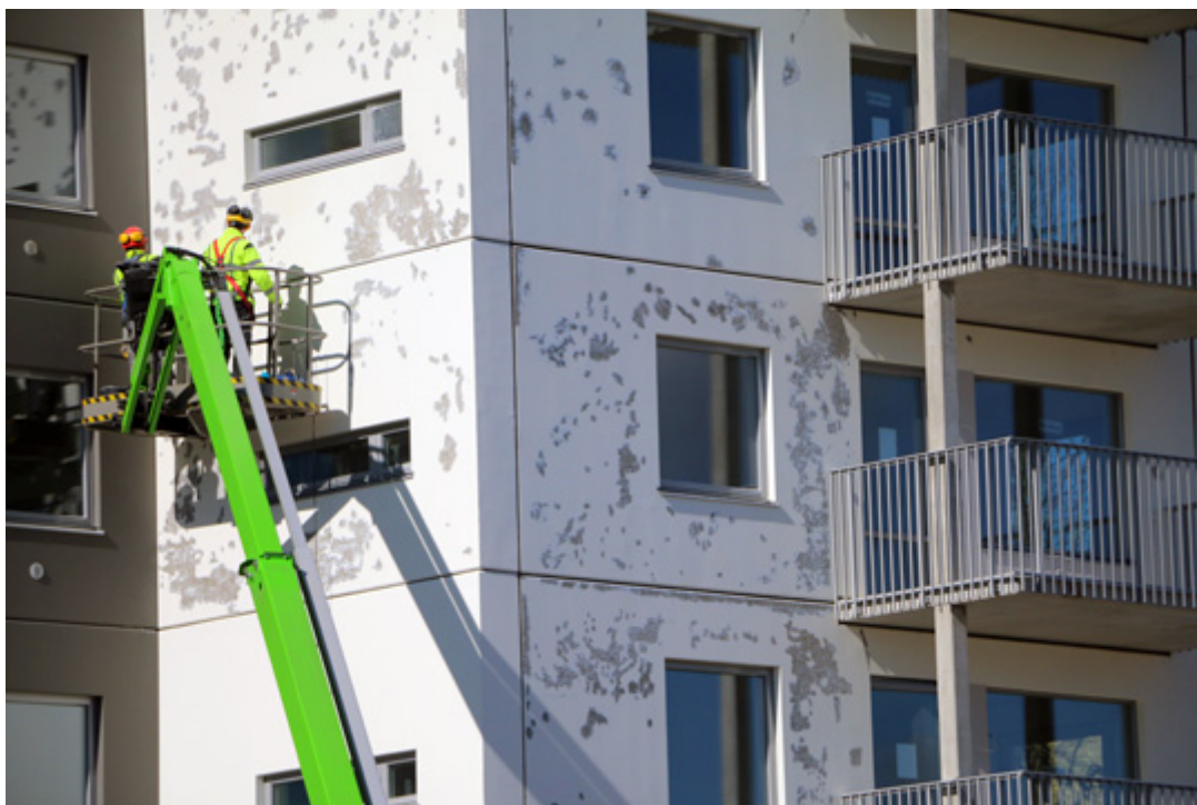
Mängder av blemmor har upptäckts på det ena höghusets fasad, som nu måste målas om. Foto: Fredrik Norman
