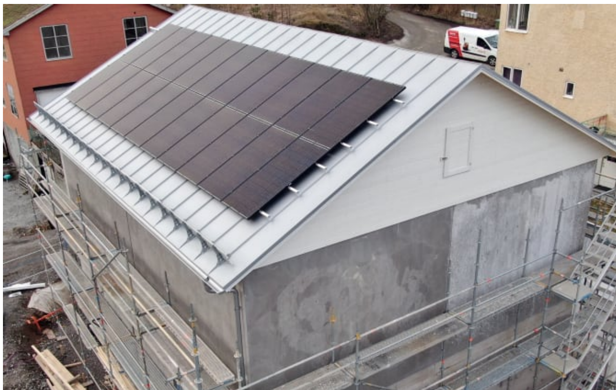
Solcellsanläggningen på Linde energis och Region Örebro läns nya filterhus. Foto: Linde energi.
