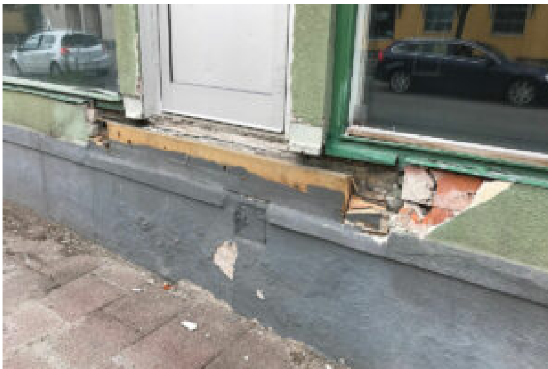
Lindesbergs Hembygdsförening anser att fastigheten fått skador då trappan togs bort. Foto: Göran Karlsson
