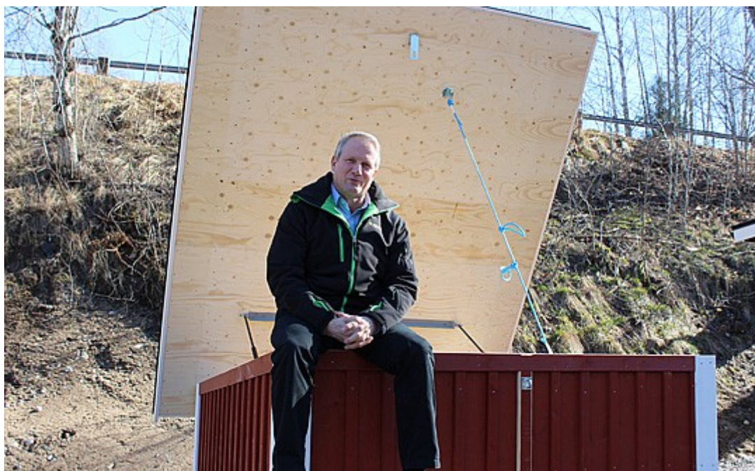
Håkan Ohlsson har hoppat upp på en av de tre "lådor" som rymmer pumpen, som hämtar kylvatten 20 meter ner. Foto: Hans Andersson
