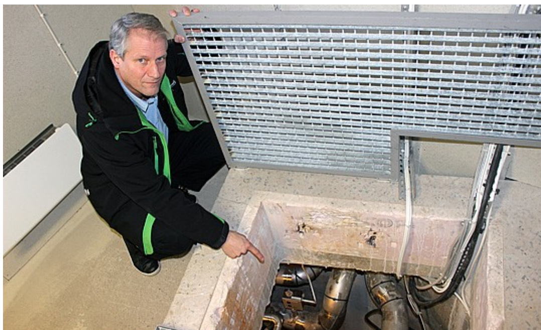
Här i pumphuset kopplas tre metallrör ihop med den vattenledning som leder vidare till lasarettet. Foto: Hans Andersson
