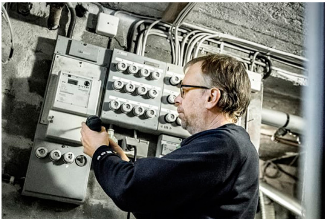
Linde energi ska byta 12 000 elmätare fram till år 2025. Foto: Linde energi.
