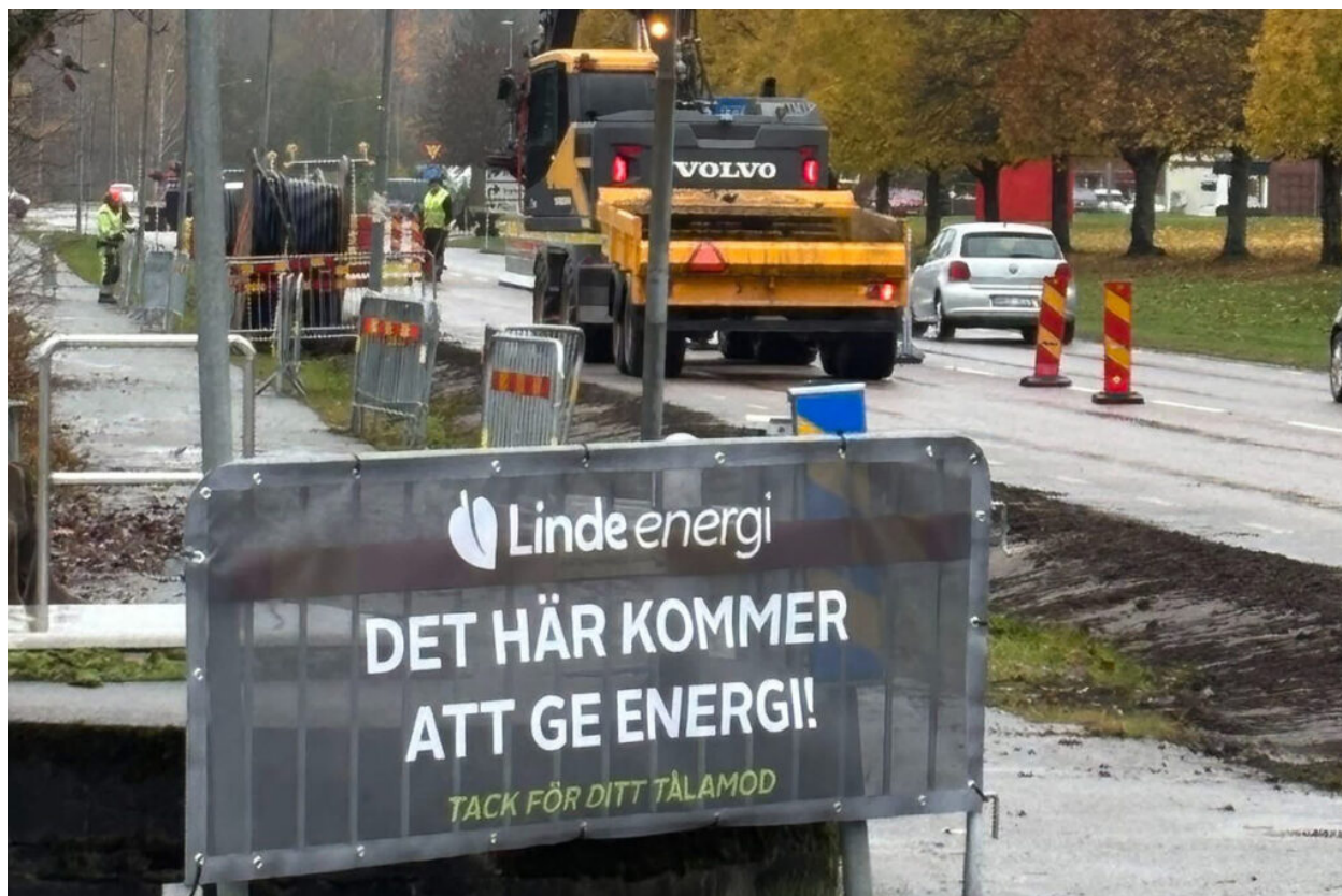
Foto: Linde energi
