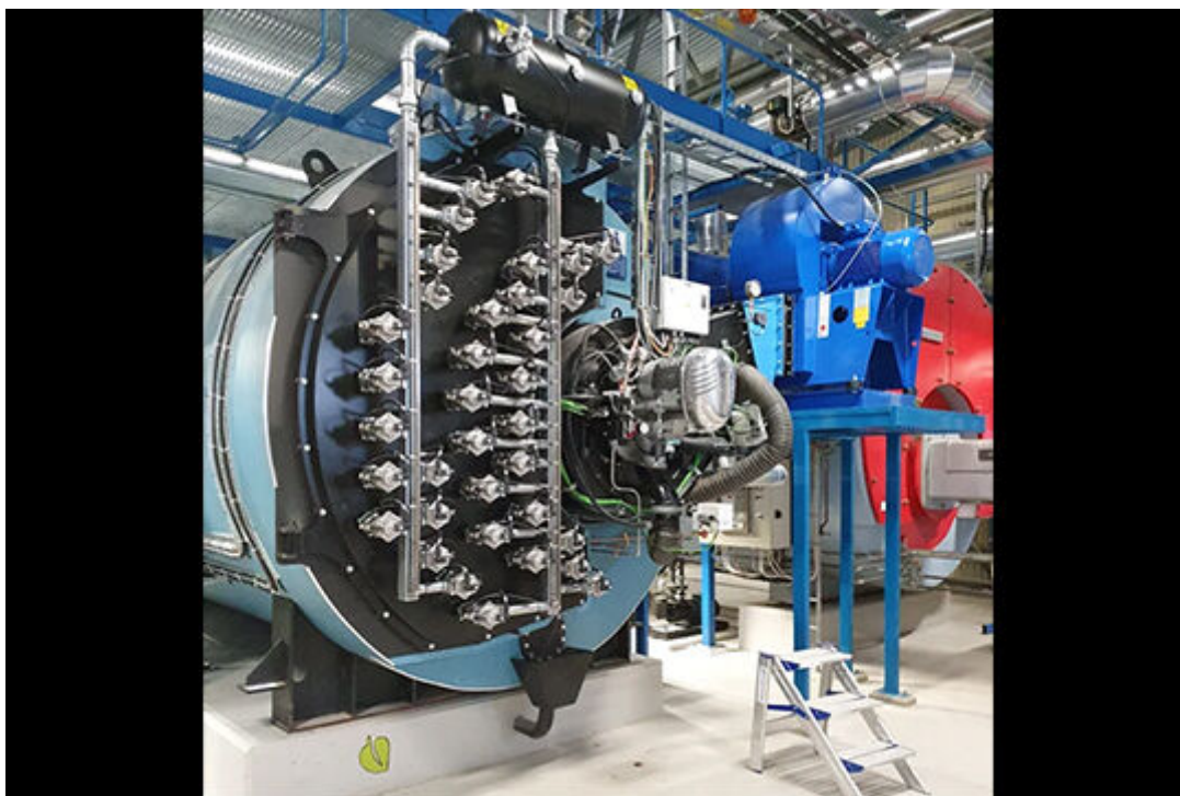
Den nya brännaren för bioolja är monterad och driftsatt. Foto: Linde energi
