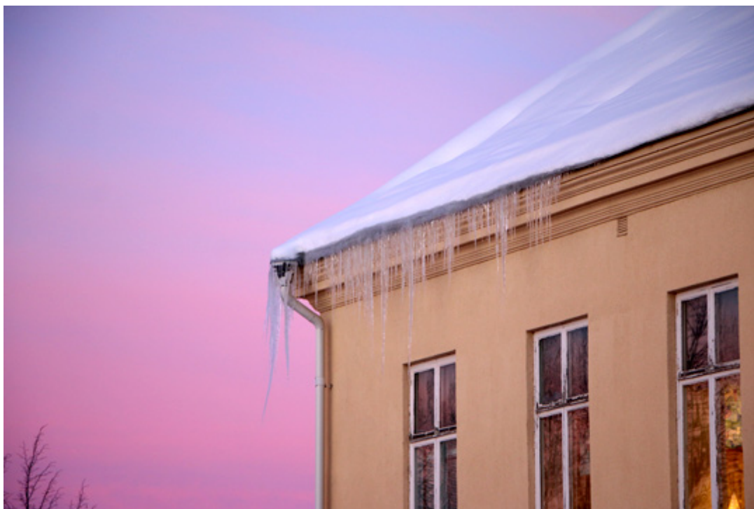
En rejäl ispjäs på Smedjegatan, som har fritt fall ned på trottoaren om det vill sig illa. Foto: Fredrik Norman
