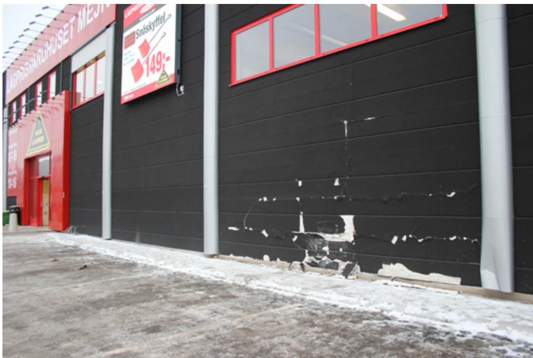
Gas istället för broms, resulterade i en rejäl skada på fasaden. Foto: Camilla Lagerman
