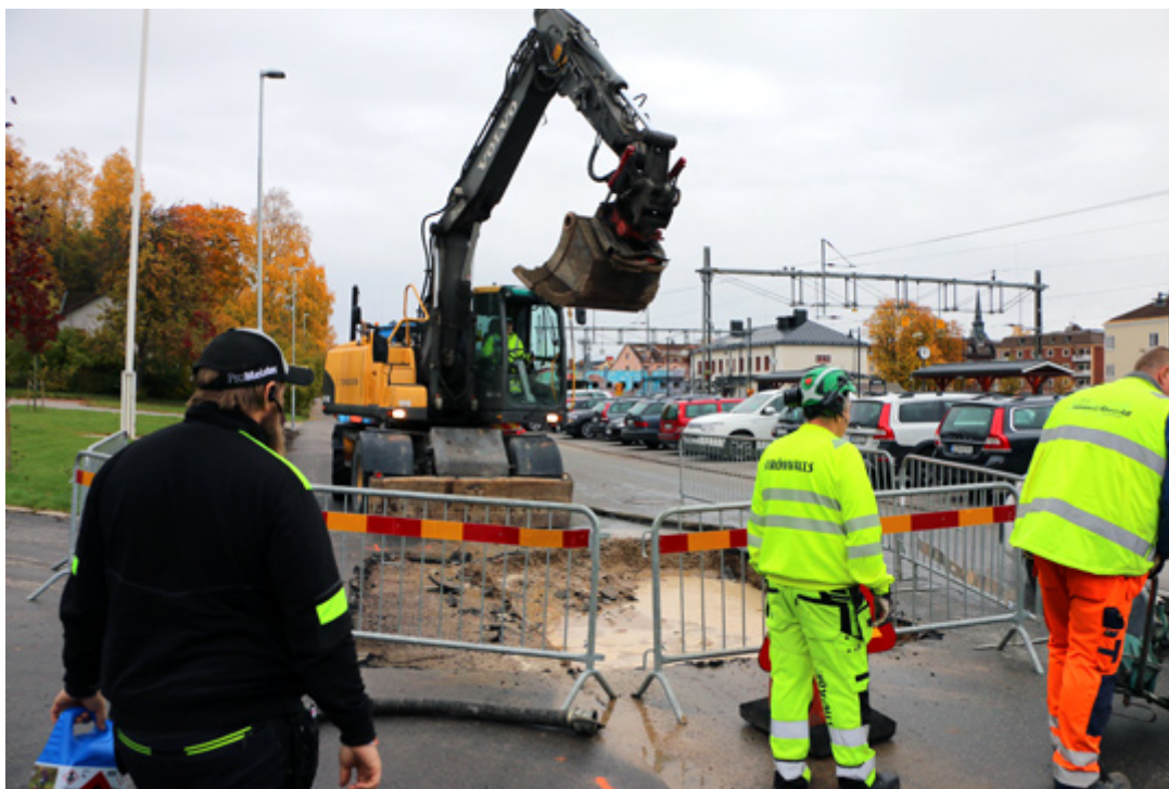
En vattenläcka har upptäckts på Banvägen i Lindesberg. Foto: Fredrik Norman
